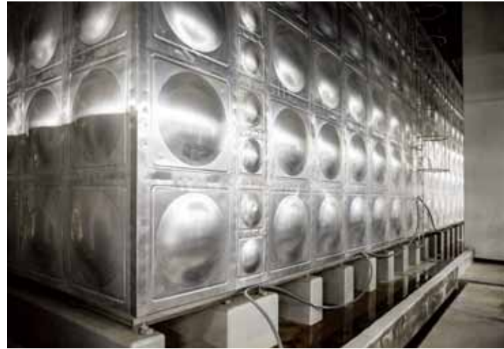
테크노돔 본관은 대체 에너지원 가운데 효율이 가장 좋은 지열을, The Residence(기숙사동)는 태양전지를 사용해 일정 수준의 에너지를 자체 충당한다. 화석연료를 사용하는 전기에 대한 의존도를 줄인다는 의미다. 본관의 축열 탱크.
